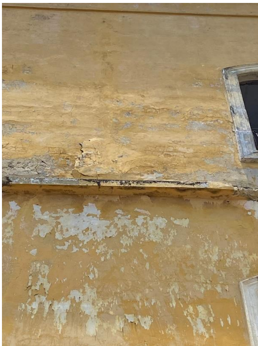
Imagen 17 – Abombamiento de pañete.
