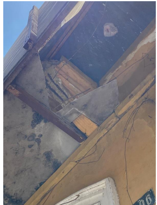
Imagen 14 – Hierros expuestos y lamina quebrada.
