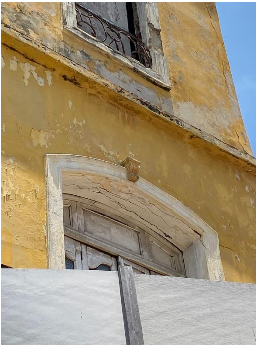
Imagen 13 – Agrietamiento de arcos y corrosión de elementos de ventana.
