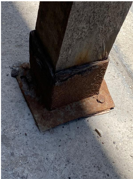
Imagen 9 – Bases de los parales completamente corroidas.
